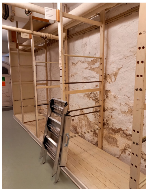
Fuktskadad vägg i benkällaren före renovering. Foto: Åsa Holmberg.
